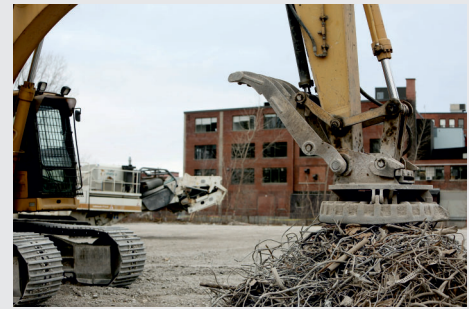
Schrottbeseitigung durch Magnetkraft
