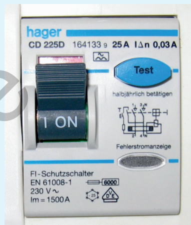
13.2. Der FI-Schalter sollte regelmäßig durch Drücken des Knopfes auf seine Funktion überprüft werden.
