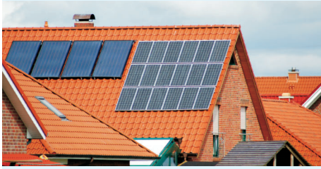
18.1. Umweltfreundlich beheizen: Sonnenkollektoren werden zur Unterstützung der Zentralheizung und zur Warmwasserbereitung verwendet.
