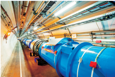
4.2. Die unterirdische Versuchsanlage in Cern ist 27 km lang. Techniker benutzen hier das Fahrrad, um von A nach B zu gelangen.
